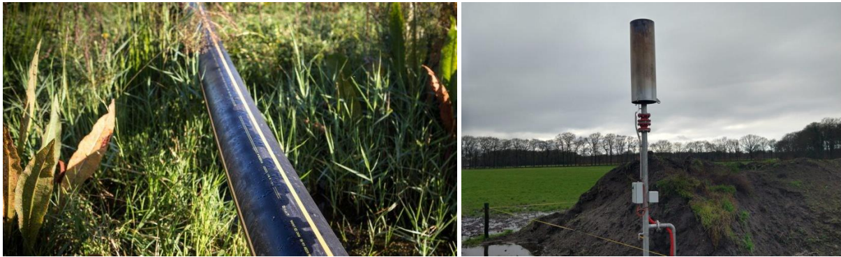
Figuur 5: Biogasleiding en biogasfakkel.
